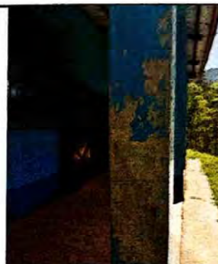
Foto 2: Pintura de Escuela Exterior por deterioro.
