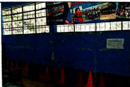
Foto 1: Pintura de Escuela interior por deterioro.
